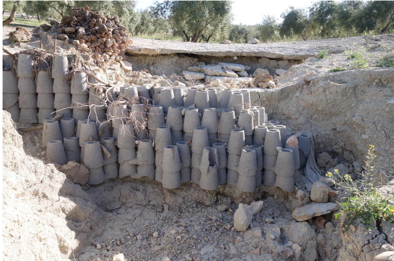
Albarrada de la serie JA-1 con descalce en la base y estribo
