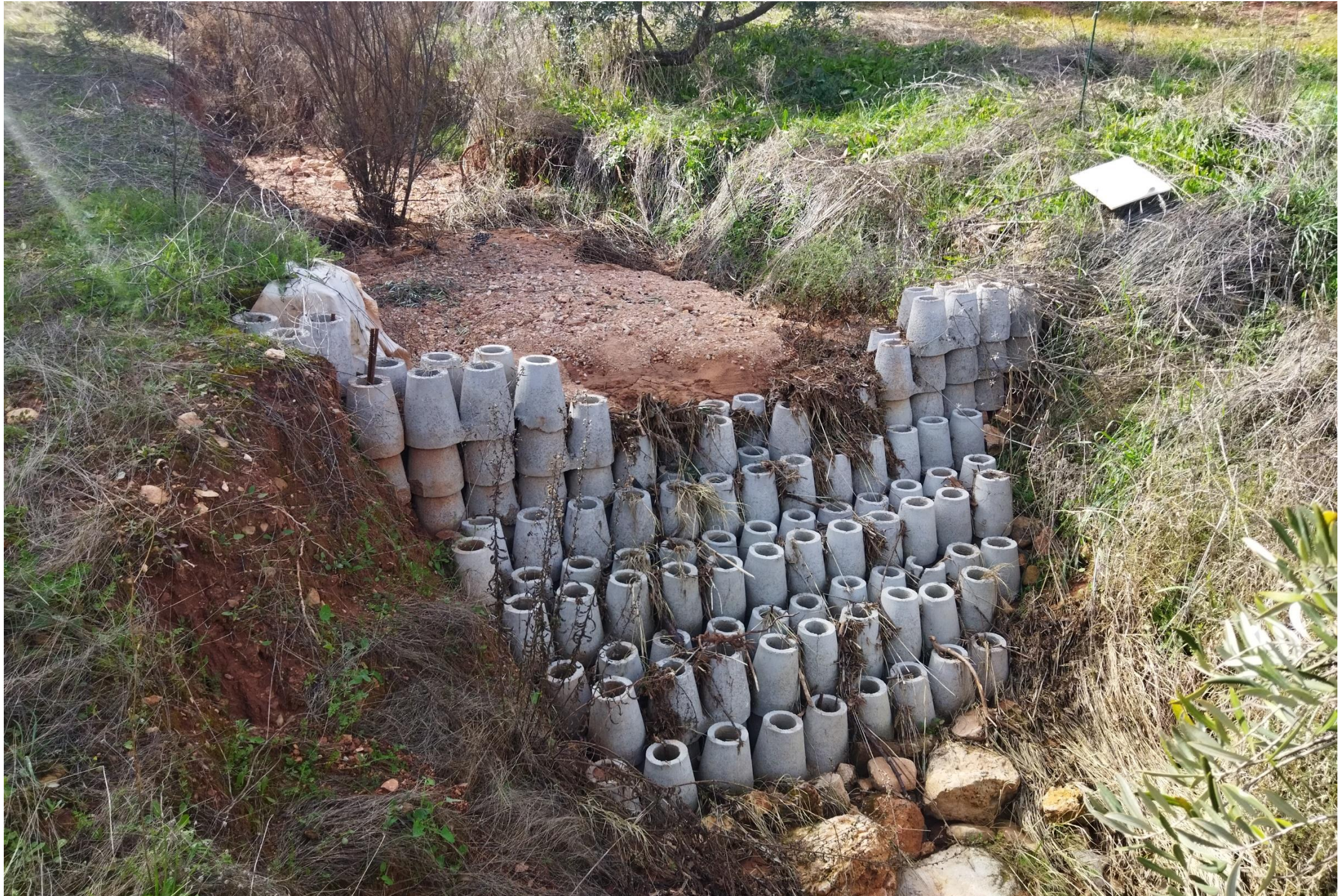
Albarrada de la serie JA-3 en febrero de 2025 totalmente colmatada tras un evento de 45 l/m 2 en 24 horas
